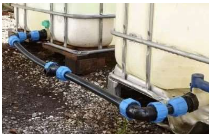
Foto 1- sistema di prova filtrazione per acque contaminate
