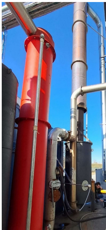
Figura 3 assetto della stazione di rilevamento a terra per il rilevamento al Pirogassificatore
